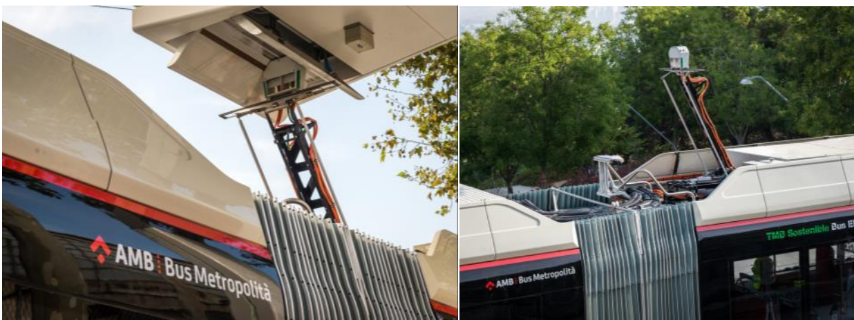
Detalle del pantógrafo acoplado a la campana del punto de carga rápida A la derecha puede verse la posición del brazo retráctil sobre el techo del Solaris Urbino 18E
