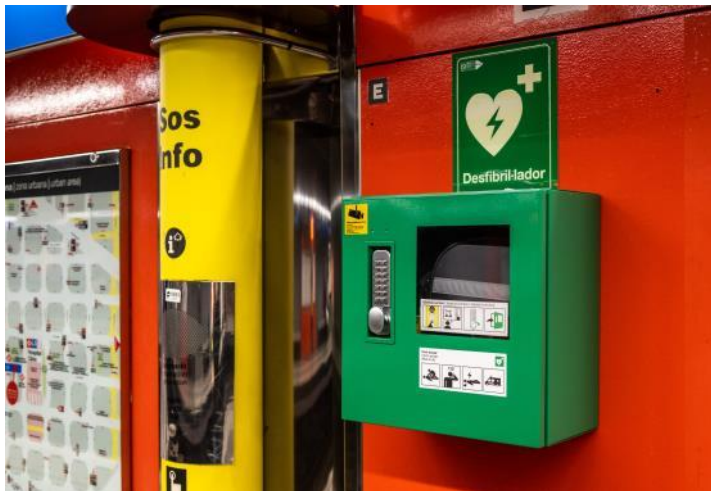
Desfibril·lador a l'estació Hospital Clínic de la línia 5 de metro
