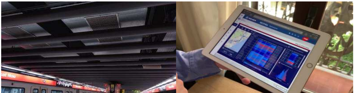
Ventilació d'una estació de la línia 1 del metro de Barcelona i consola de monitorització del sistema / © SENER
