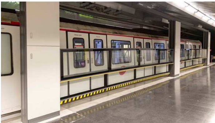
Mòduls de portes d'andana verticals instal·lats en el metro de Barcelona per a la prova pilot
